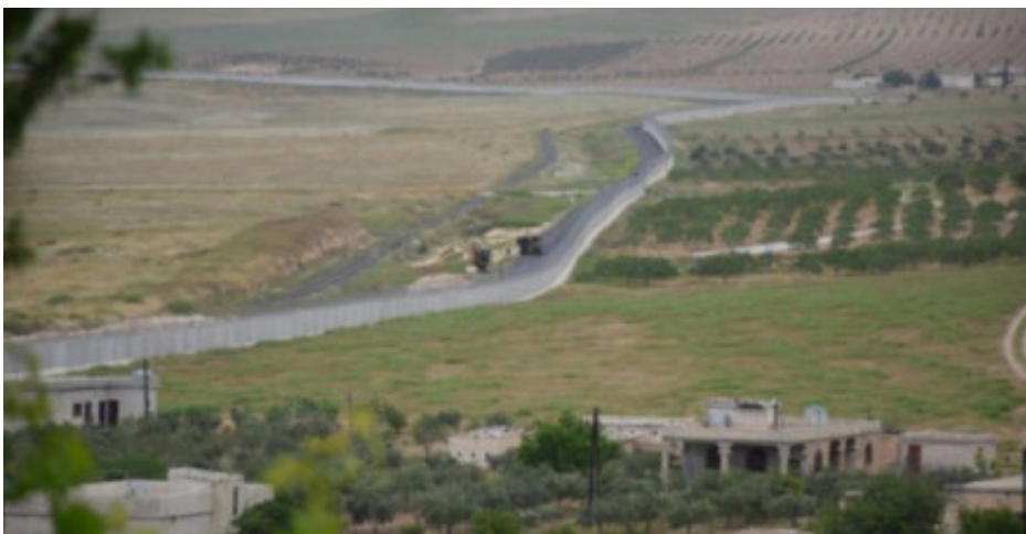
Les forces turques, creusent, depuis plusieurs jours, des tranchées de 3 à 4 mètres de profondeur à la frontière entre le Nord-Kurdistan (Turquie) et le Rojava (Nord de la Syrie).
