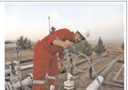
Raffinerie de Tak Tak à Erbil, capitale de la région autonome du Kurdistan. © Reuters
